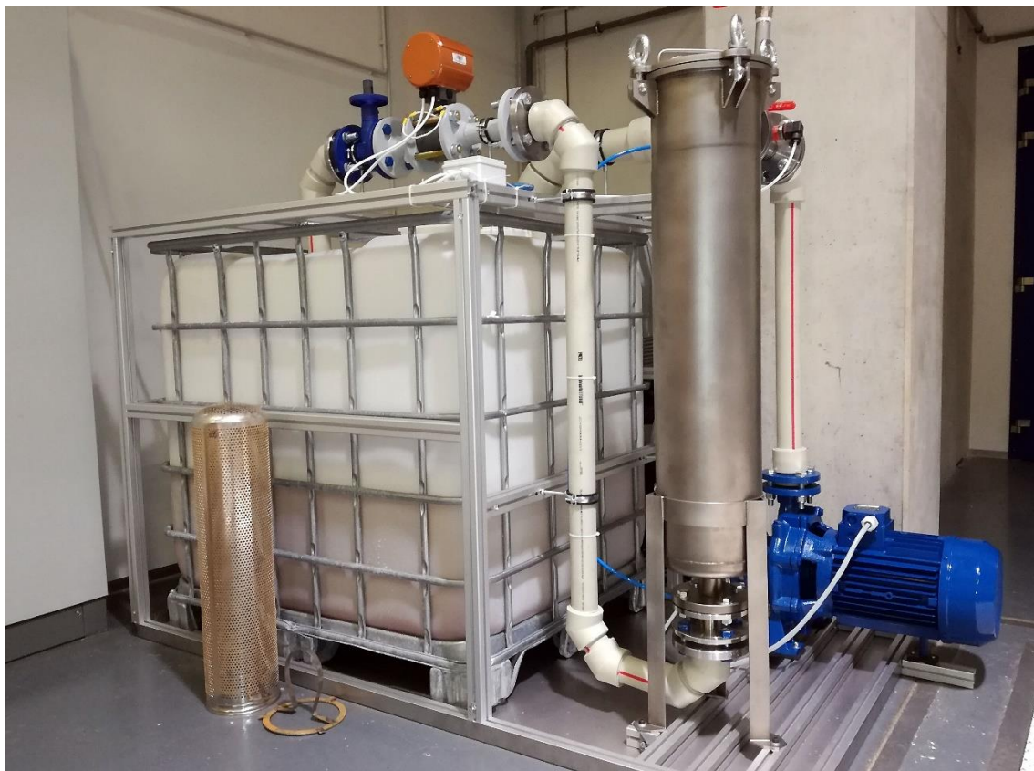
Obrázek 6 fotografie kompletní filtrační tratě
